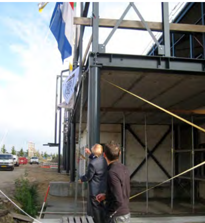
Oktober 2009: Kerstraat 40 tot en met 44 De vlag hijsen tijdens bouw nieuw kantoor.
