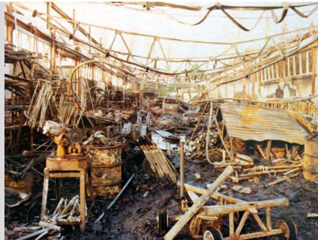
November 1978: Schade na de brand
